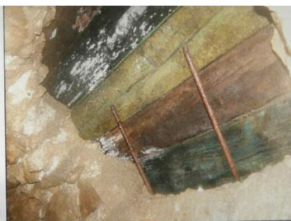
Portion B – PM7 – Niche en PDD sup/NVD Madriers en bon état apparent. Aciers corrodés
