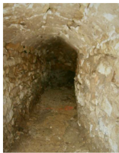
Portion A : PM17 – Bombement en PDD Evasement/aplanissement de la voûte
