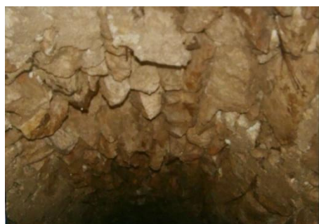
Portion B : PM2 – Erosion de la maçonnerie en voûte (vue vers le Sud)
