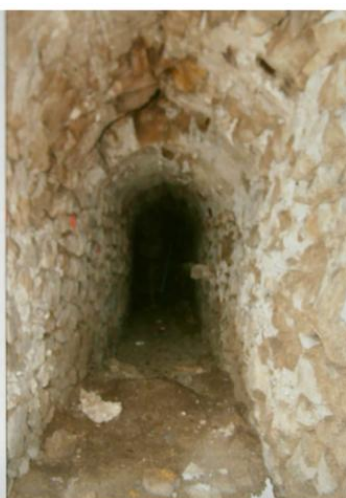
Portion A – PM4 – Bombement en PDD Ecrasement de la voûte
