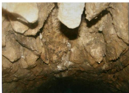
Portion B : PM6 – Maçonnerie manquante en voûte
